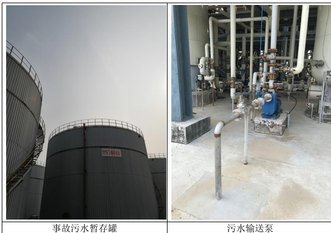
图 4-2 项目一期污水设施图片
