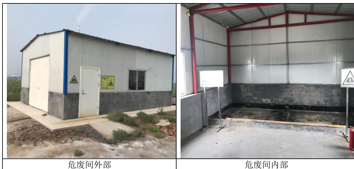
图 4-3 项目危废暂存间
